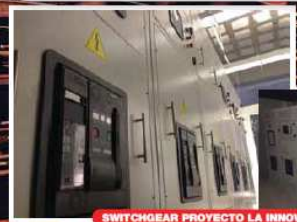
SWITCHGEAR PROYECTO LA INNOVACION (2014)
