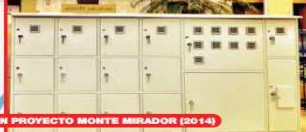
MODULO DE MEDICION PROYECTO MONTE MIRADOR (2014)
