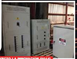
PANELBOARDS PROYECTO LA INNOVACION (2014)
