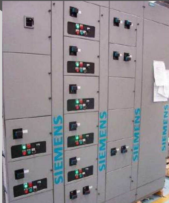
CCM = CENTRO DE CONTROL DE MOTORES
